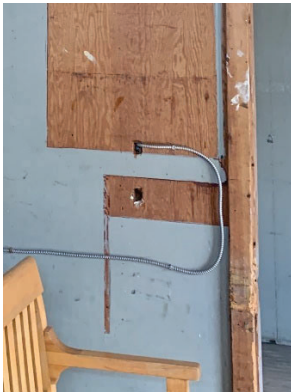
Câblage qui passe à travers la cloison (non conforme)
