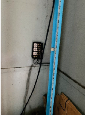
Panneau à fusible dénudé
