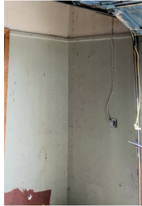
Manque couvert sur l'interrupteur
